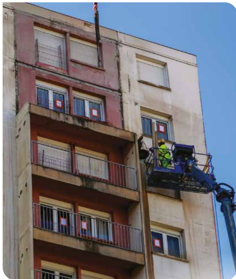
Projet de réhabilitation avenues Bohn-Alsace-Koechlin (BAK) à Belfort Phase 1 : Remplacement de balcons
